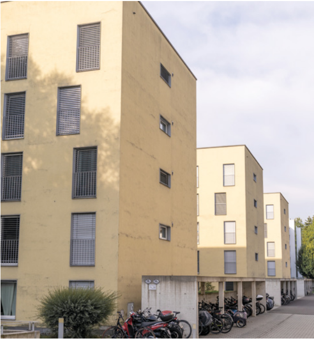
Einzelne Fassadenteile der Wohnüberbauung in Luzern wiesen Schäden auf.
