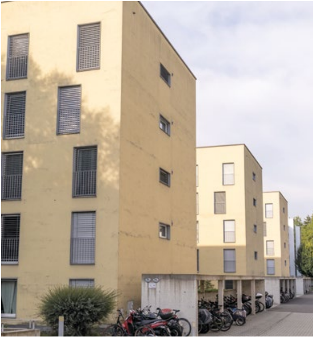
Certaines parties de la façade de l'immeuble d'habitation à Lucerne présentaient des dommages.
